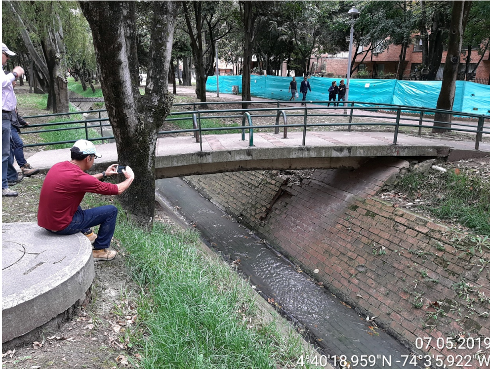
Fotografía 6. Evidencia de la fractura de losas y vegetación emergente en el Canal Virrey con coordenadas 4°40'19,114" N – 74°3'6,197" W.
